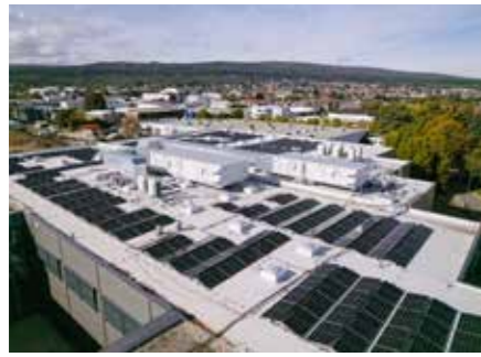
屋上にはソーラーパネルを設置
